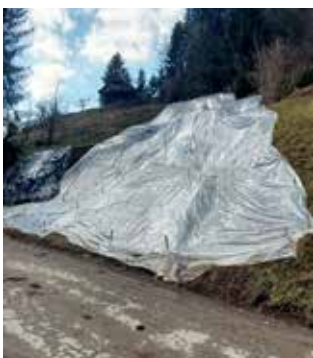
Sanacija plazju nad cesto
